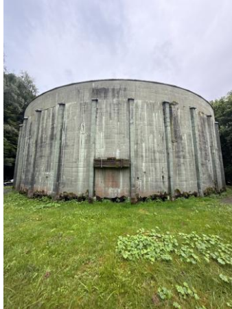
Bestehende Kläranlage Wildflecken mit Tropfkörper · Foto Daniel Kleinheinz
